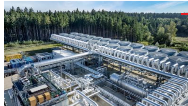
SWM - StadtWerke München Kirchstockach (Munich), Germany
